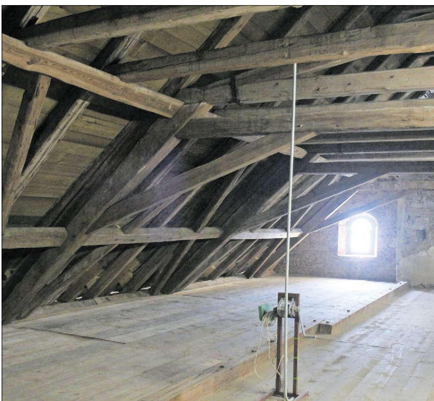
▲ Der Dachstuhl der Pfarrkirche lässt heute nicht mehr vermuten, dass einiges im Gebälk bereits morsch war. Fotos: Stiegler
